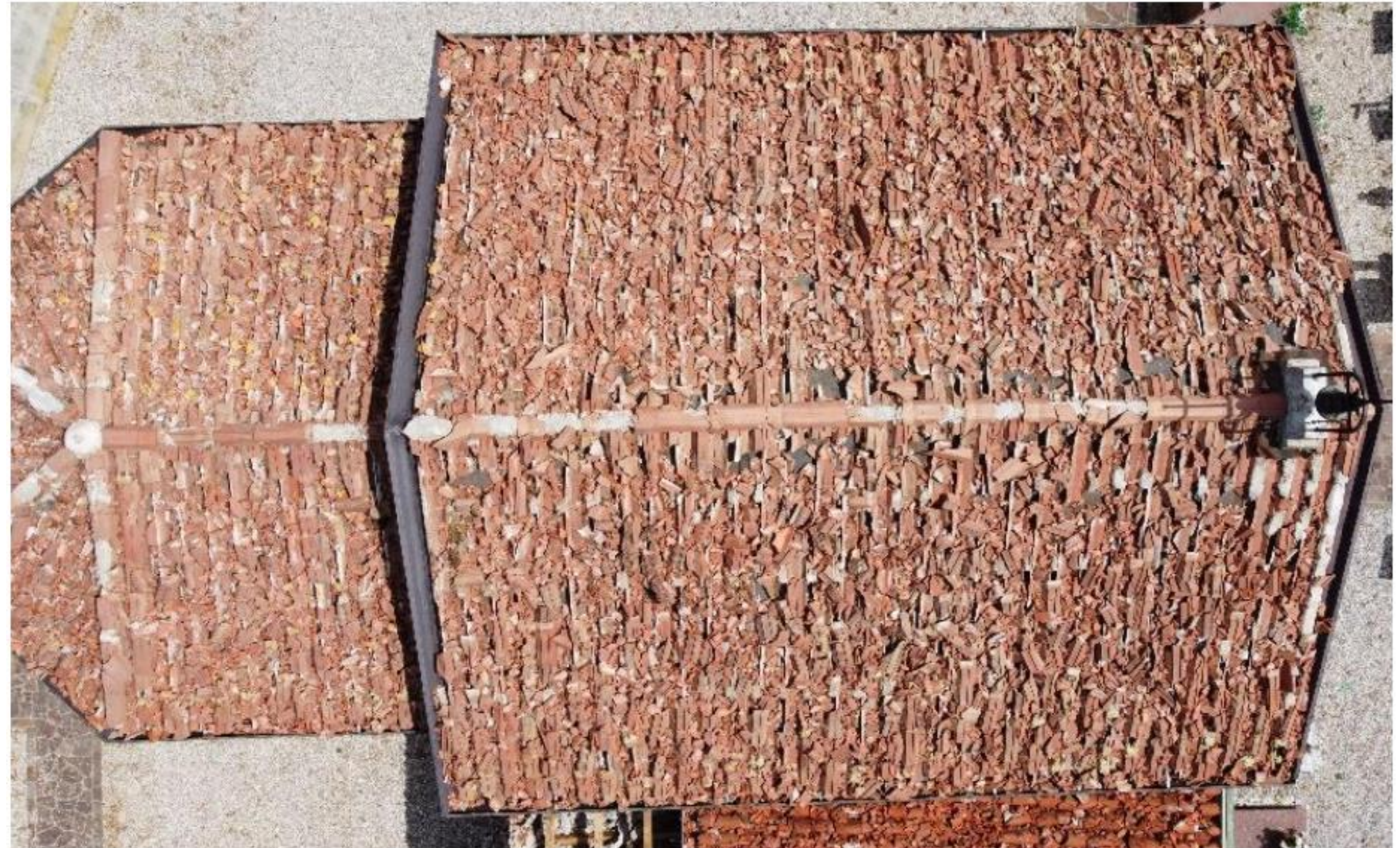
Tetto della cappella cimiteriale di Lestizza dopo gli eventi del 24-25 luglio 2023 (foto di Alberto Villani)
