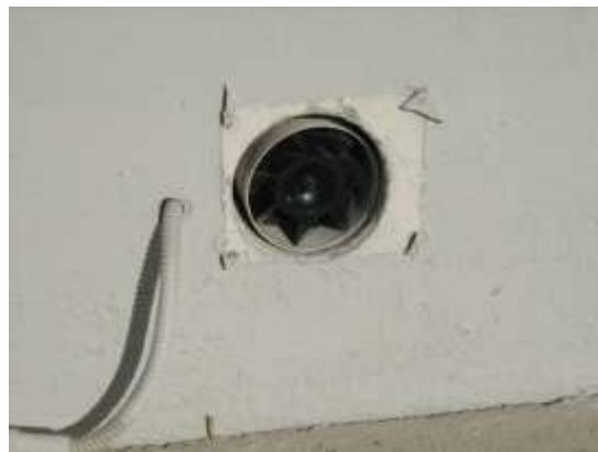
Particolare di uno dei ventilatori
