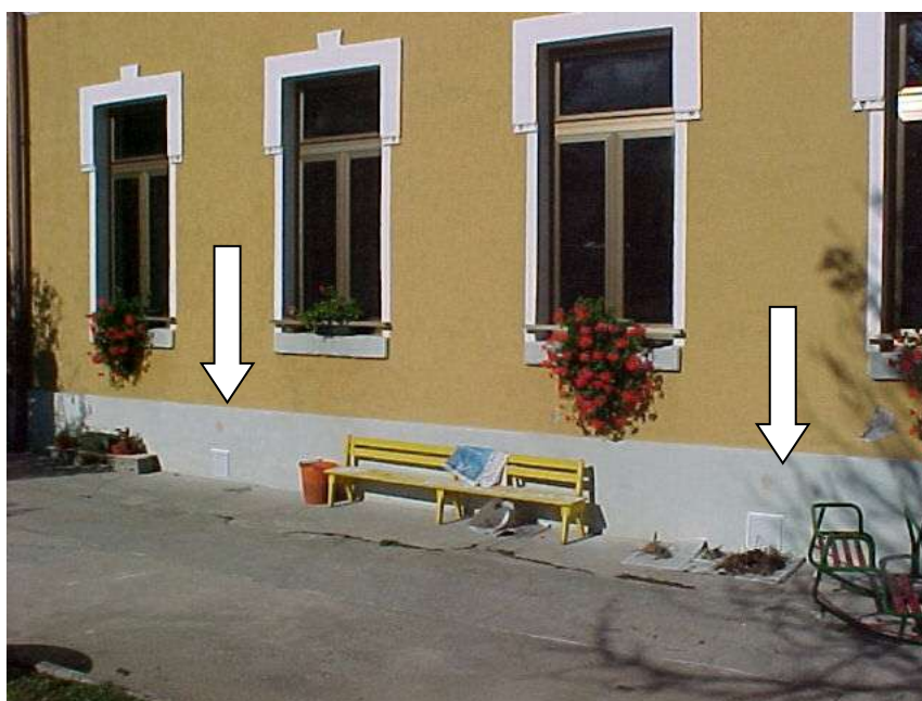
Intervento di ventilazione naturale del vespaio. Le frecce indicano le griglie che coprono i fori effettuati
