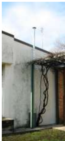
Particolare di uno dei tre sistemi di depressurizzazione
